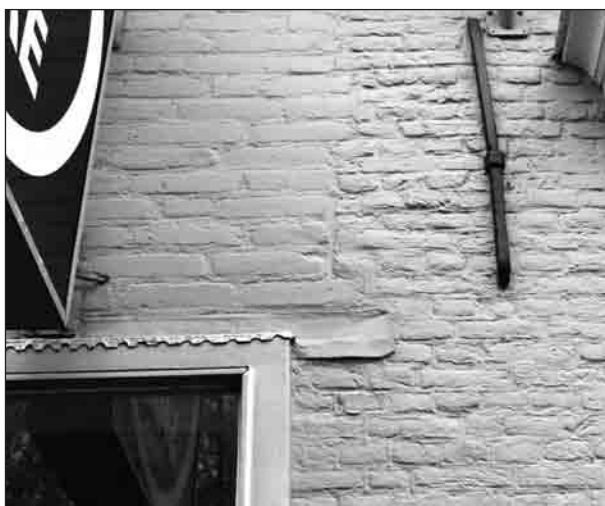
De overgang van moderne stenen en oude ijsselsteentjes in de voorgevel, gevolg van het vervangen van het oude muurdeel met de twee ramen (links van de ingang). FOTO PS
